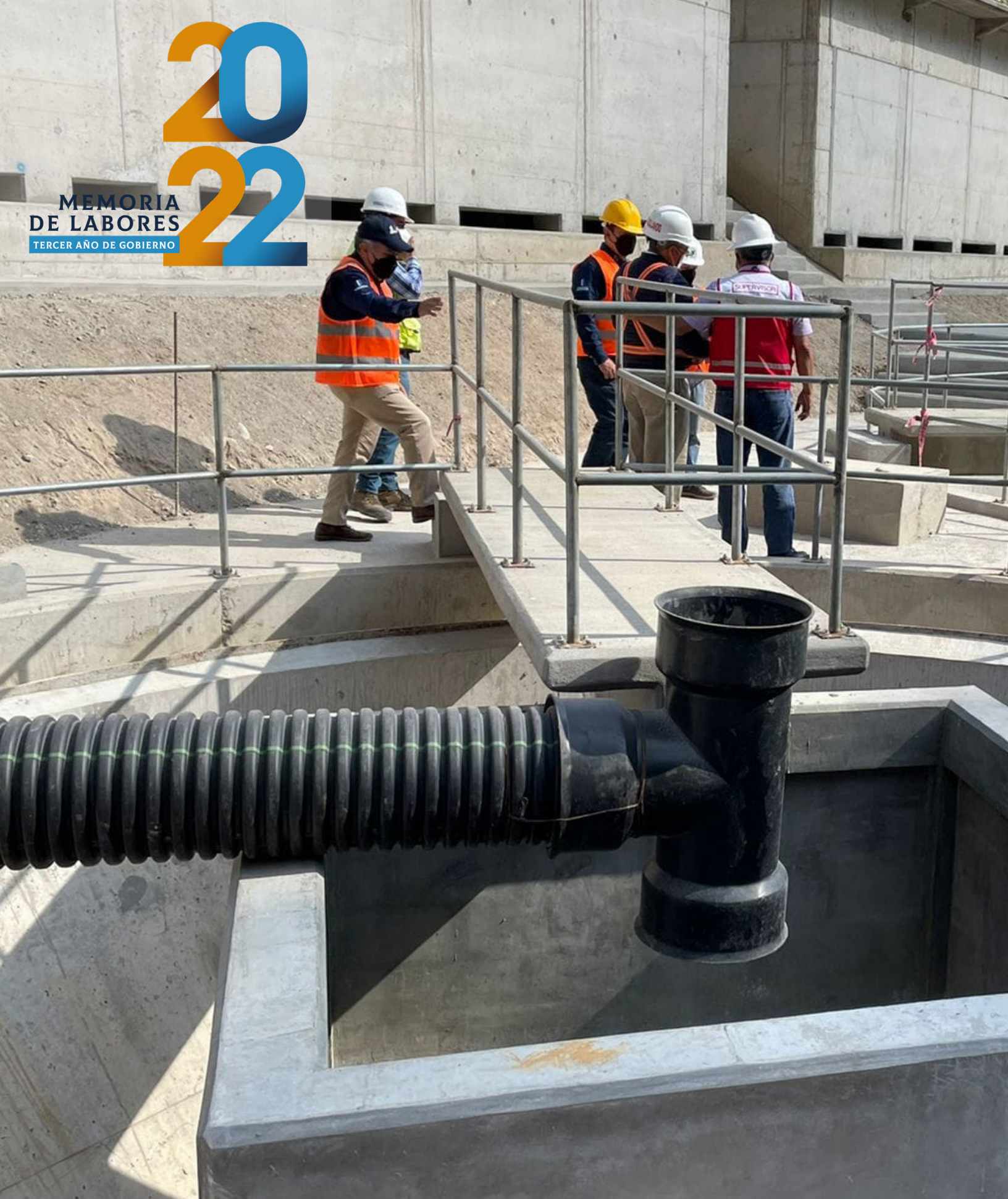
PLANTA DE TRATAMIENTO "LA BÓVEDA" San Marcos, San Marcos / Obra INFOM-BID
