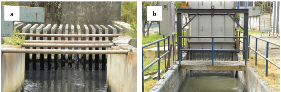
Figura 1.5. Rejillas y sistemas de desarenado. a) Planta de tratamiento de aguas residuales municipales, Brasil b) Planta de tratamiento de aguas residuales municipales Cerro de la Estrella, México.
