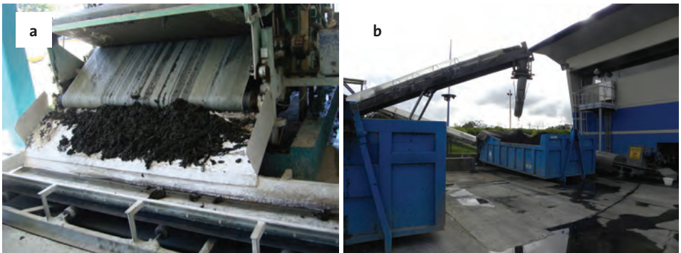
Figura 1.18. a) Filtro banda de la planta de tratamiento de aguas residuales Sur, Querétaro, México, b) Manejo de lodos residuales de la planta de tratamiento de aguas residuales de la Calera, Colombia.
