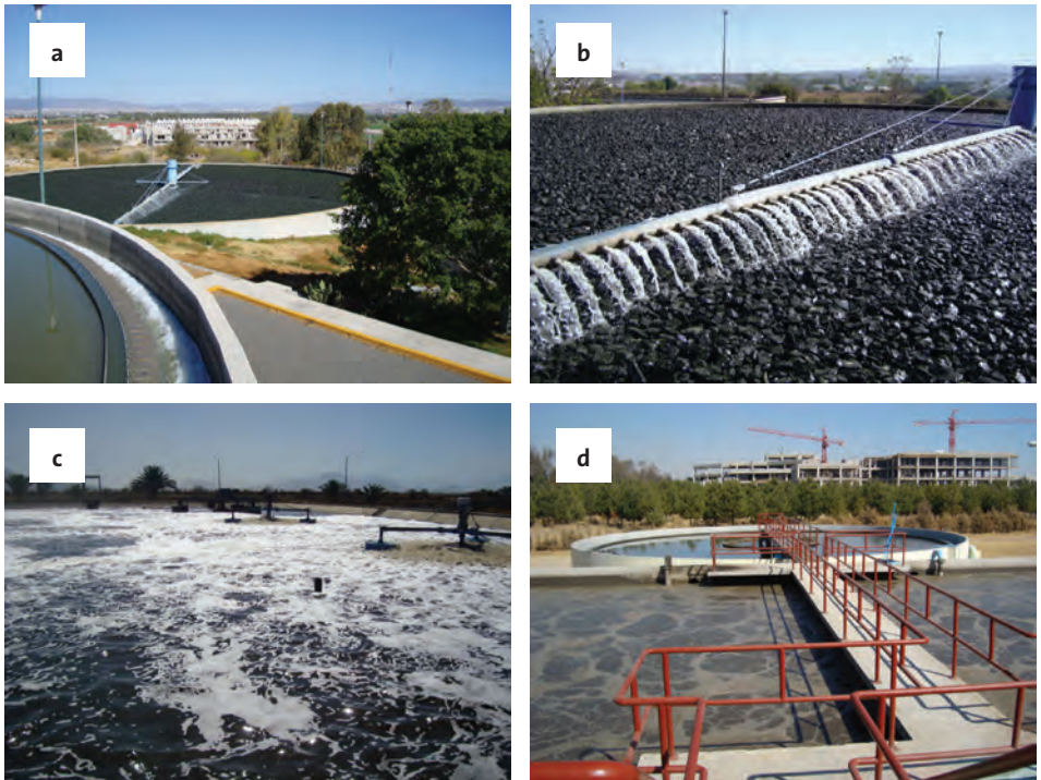
Figura 1.19. a) y b) Filtro percolador de la planta de tratamiento de aguas residuales sur, Querétaro, México, c) Laguna aireada de la planta de tratamiento de aguas residuales de Lago de Texcoco, México, d) Reactor aerobio de la planta de tratamiento de aguas residuales de Metepec, México.
